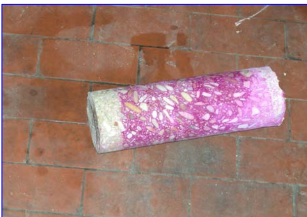
Determinazione della profondità di carbonatazione su carota in cls in sito.
