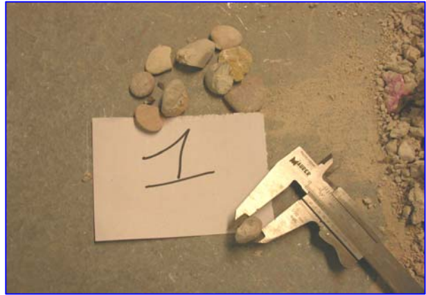
Misurazione grandezza inerti ricavati da carota in cls estratta da pilastro P1 (parte bassa).
